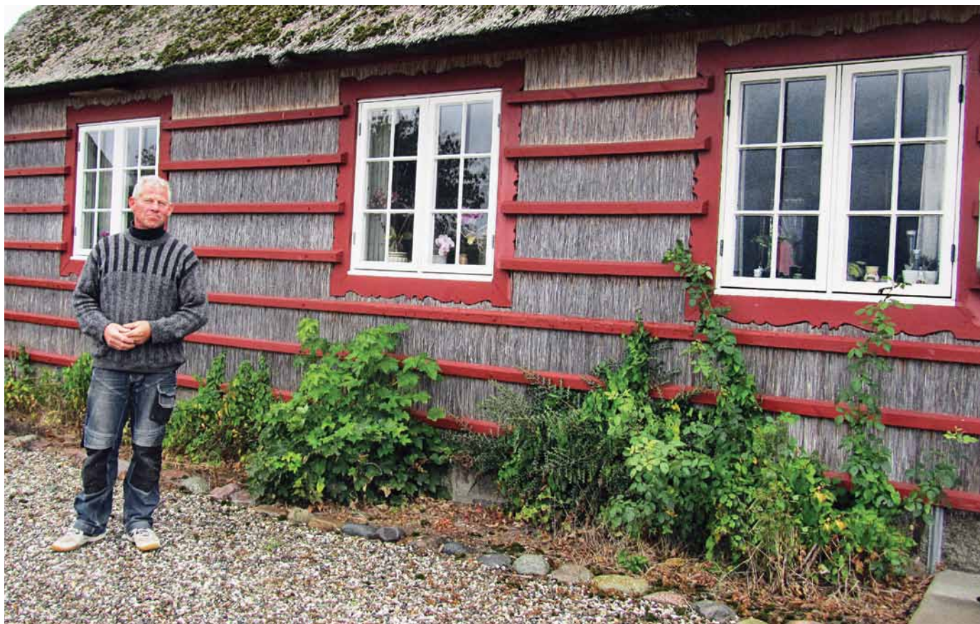
De særlige rørvægge ses i rigt mål på Hesnæs og er løsningen på problemet med havets påvirkning af murene
