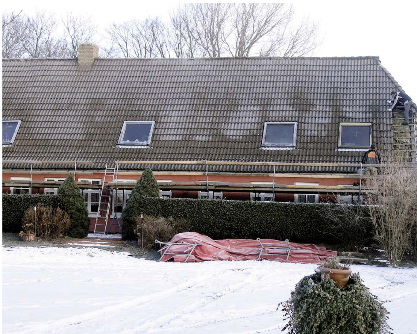
▲ ►Før og efter. Argumenterne skal være i orden, men så kan det også blive muligt at skifte fra et kedeligt fast tag til Smukt stråtagt, der igen yder huset fuld retfærdighed. Tækkearbejdet er udført af John Briston
